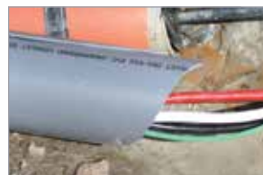
SECTION DE CONDUIT CASSÉE
