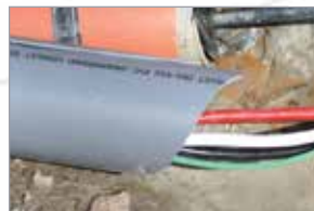
SECTION BRISÉ DU CONDUIT
